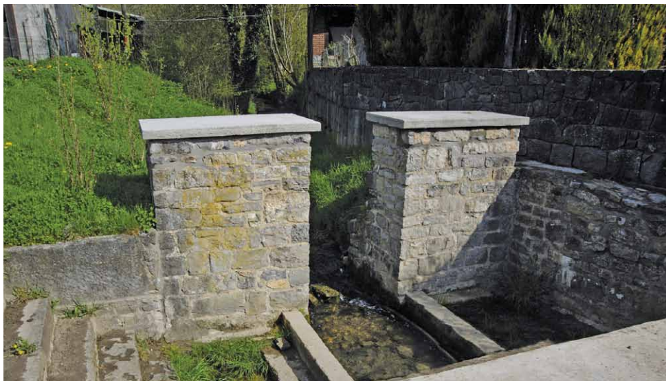
Édifice en moellons de calcaire restauré en 2012. Rue de Fagnolle. GPS : 50.05.556 N 004.35.444 E
